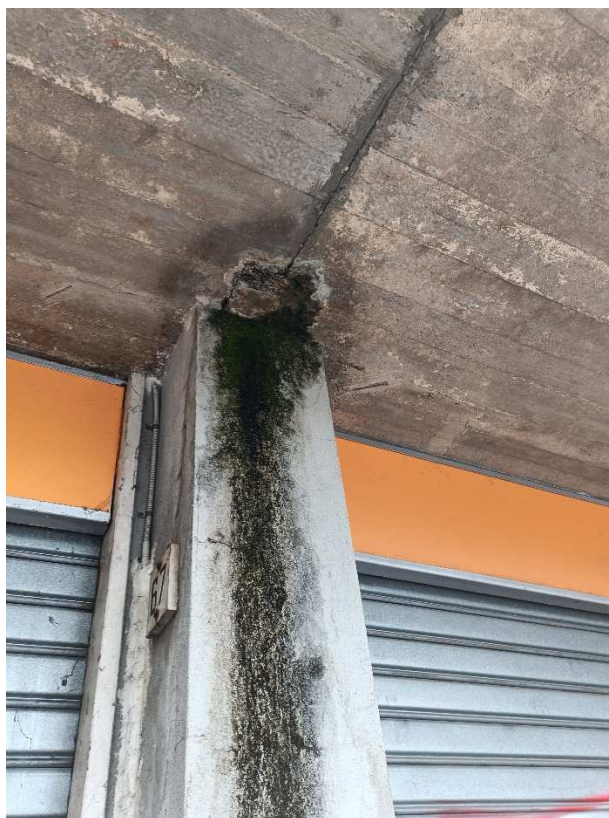
Particolare degrado facciata su via Copernico
