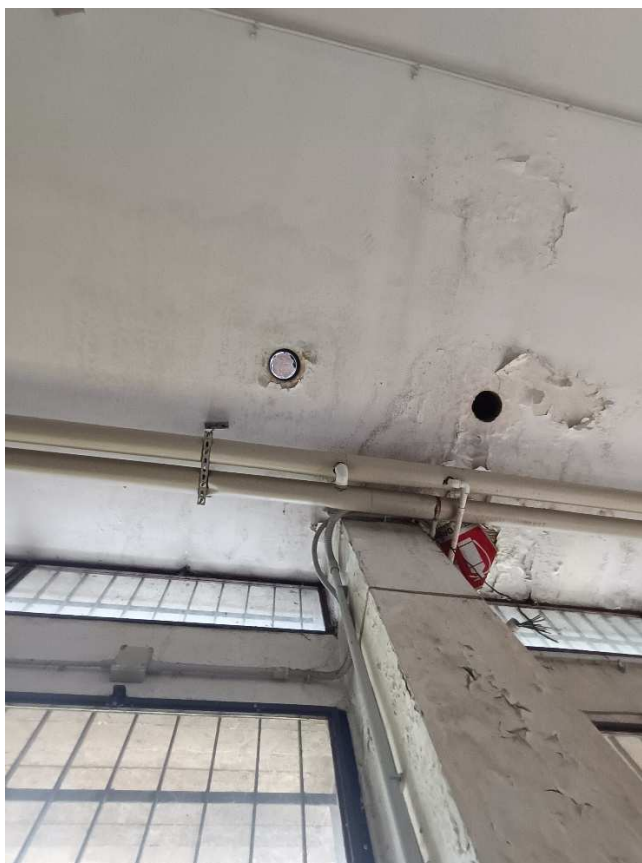
Locale 2 – soffitto con foro aperto e infiltrazioni
