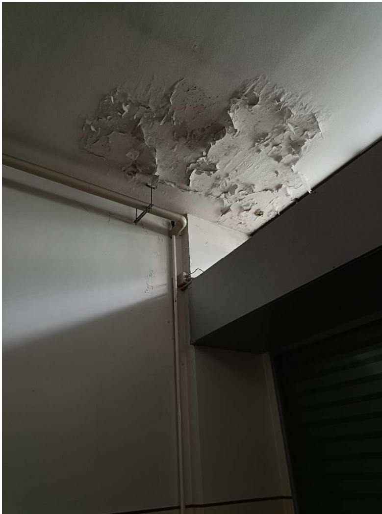
Locale 1 – particolare infiltrazioni soffitto
