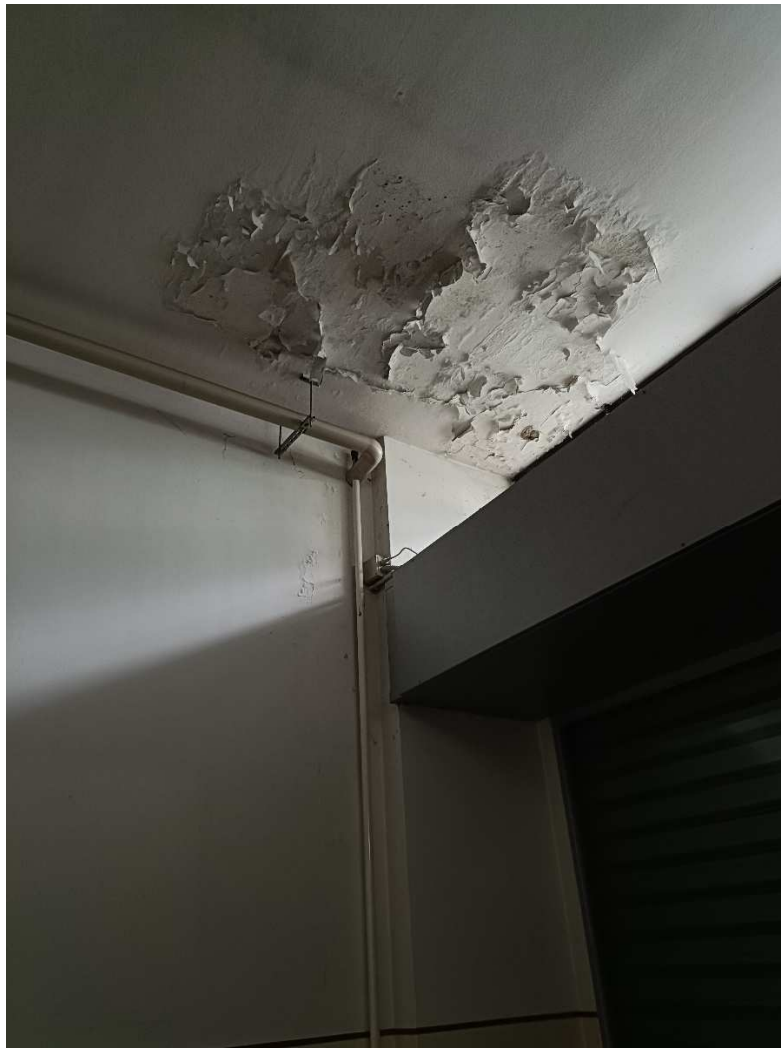
Locale 1 – particolare infiltrazioni soffitto
