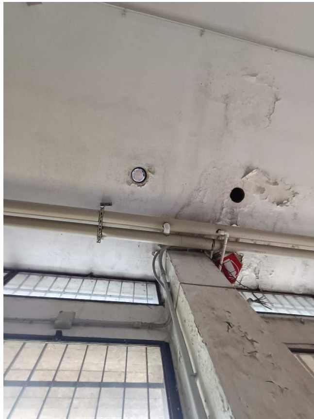
Locale 2 – soffitto con foro aperto e infiltrazioni
