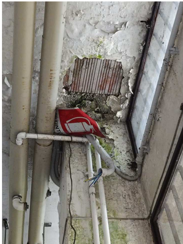
Locale 2 – soffitto con infiltrazioni e parziale distacco dell'intonaco
