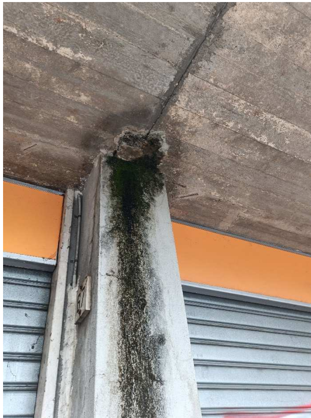
Particolare degrado facciata su via Copernico
