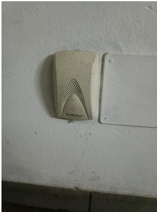
quadro elettrico e
