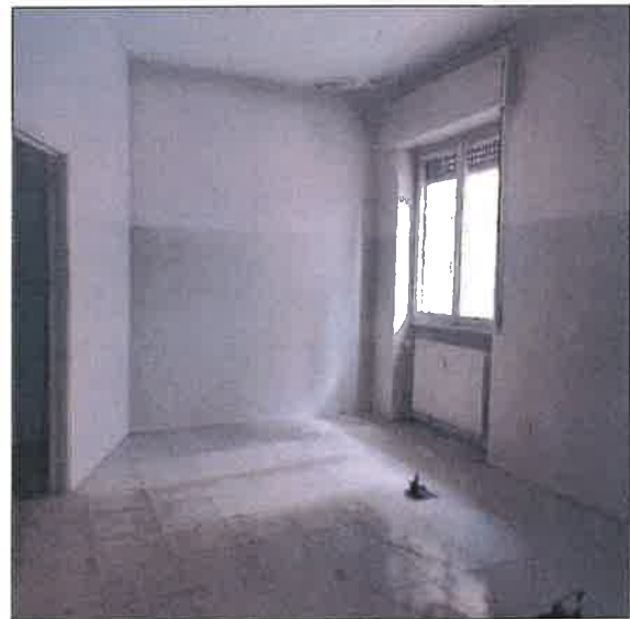
Interno con gli attacchi a pavimento degli impianti medicali
